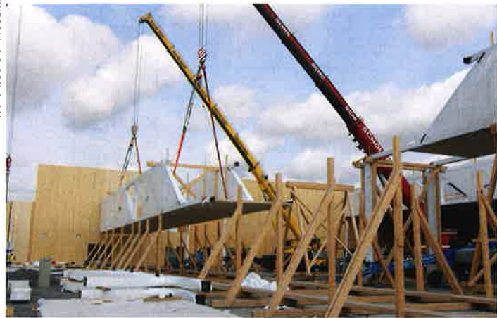
Anheben eines Shed-Graben-Teils, der mit Hilfe eines Leagerüsts aus zwei Fachwerkbinder-Teilen und BSP-Platten als „Grabensole“ auf der Baustelle zusammengebaut wurde.
